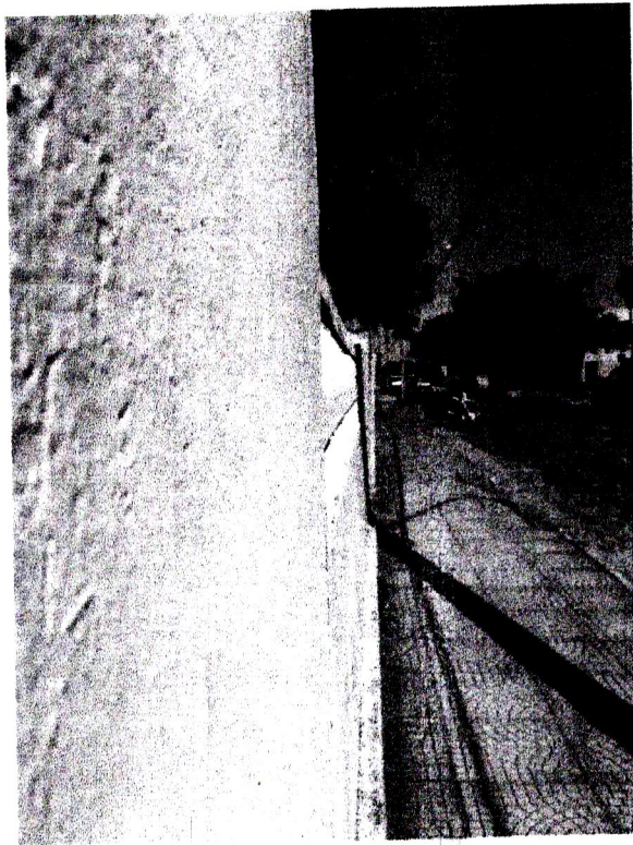
Figura 4 - Alinhamento do muro comprometido
